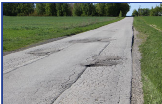
Stan drogi przed modernizacją.
