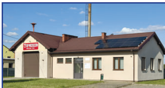
Instalację fotowoltaiczną zamontowano na budynkach OSP na początku października.
