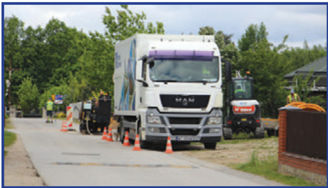
Prace ziemne przy budowie sieci gazowej w rozpoczęły się w maju br.
